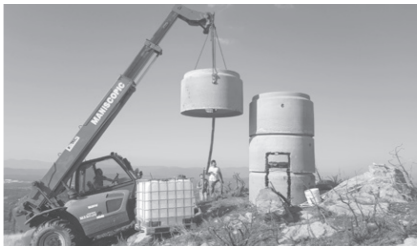
4.3 Recorte de janela em anilha de betão armado. Fotografia por Miguel Seabra. Window cutout on reinforced concrete ring. Photograph by Miguel Seabra.
